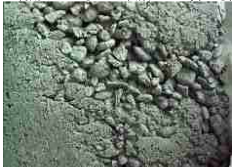
コンクリートの打設不良、ジャンカ
